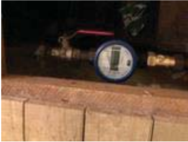
Måler placeret under gulv
